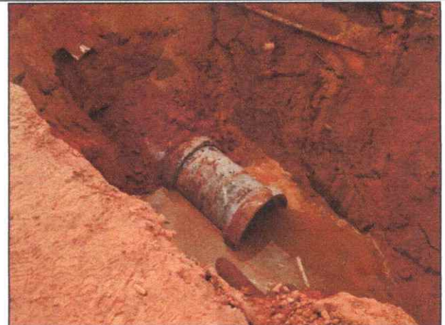
Foto 32 - R. CORONEL MANOEL BANDEIRA - CENTRO - TUBO DE CONCRETO ARMADO PA2 - D= 0,60 M.
