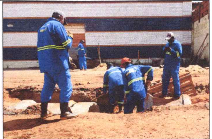
Foto 20 - AV. SÃO SEBASTIÃO - VILA NOVA - TUBO DE CONCRETO ARMADO PA2 - D= 0,80 M.
