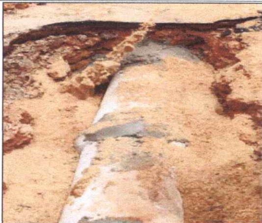
Foto 27 - R. GOIÁS – TRÊS PODERES - TUBO DE CONCRETO ARMADO PA2 - D= 0,60 M.
