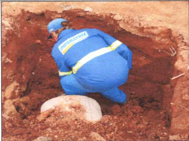
Foto 23 - AV. NEWTON BELLO – VILA CAFETEIRA - TUBO DE CONCRETO ARMADO PA2 - D= 0,60 M.
