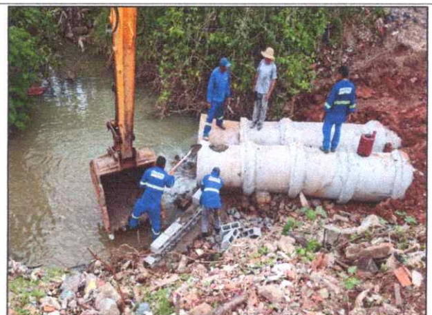
Foto 34 - R. SETE DE SETEMBRO - BACURI - TUBO DE CONCRETO ARMADO PA2 - D= 0,80 M.
