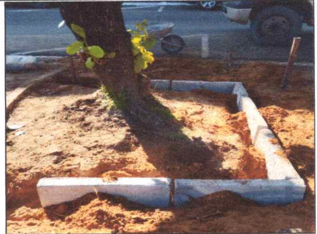
Foto 42 – R. BENEDITO LEITE - CENTRO - MEIO FIO DE CONCRETO 80 CM.
