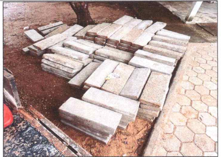
Foto 2 - R. RAFAEL DE ALMEIDA RIBEIRO - SÃO SALVADOR – MEIO FIO DE CONCRETO 80 CM.
