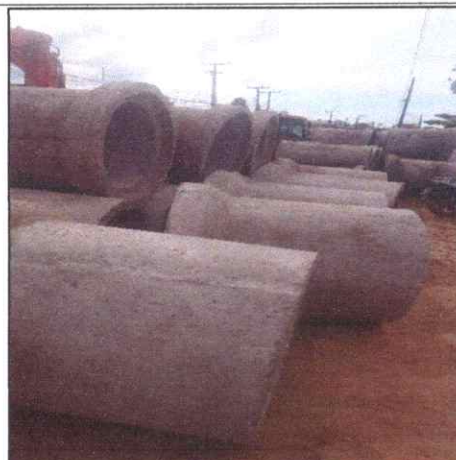
Foto 8 - AV. SÃO SEBASTIÃO - VILA NOVA - TUBO DE CONCRETO ARMADO PA2 - D= 0,80 M.
