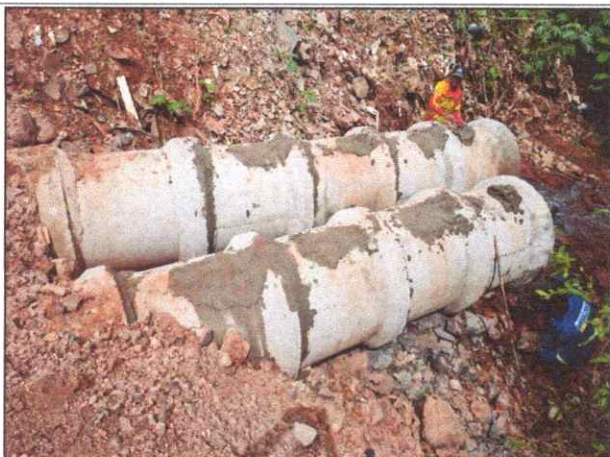
Foto 33 - R. SETE DE SETEMBRO - BACURI - TUBO DE CONCRETO ARMADO PA2 - D= 0,80 M.
