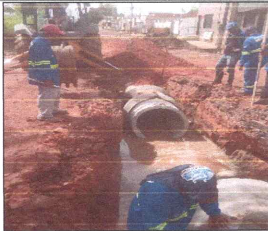
Foto 16 - AV. SÃO SEBASTIÃO - VILA NOVA - TUBO DE CONCRETO ARMADO PA2 - D= 0,80 M.
