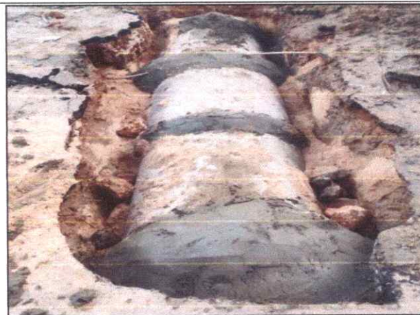
Foto 31 - R. PARAÍBA - TUBO DE CONCRETO ARMADO PA2 - D= 0,80 M.
