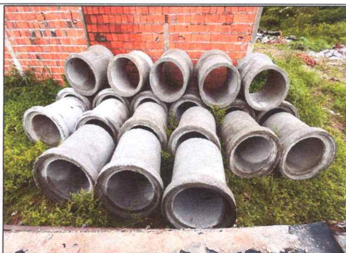
Foto 4 - R. SETE DE SETEMBRO - TUBO DE CONCRETO ARMADO PA2 - D= 0,80 M.
