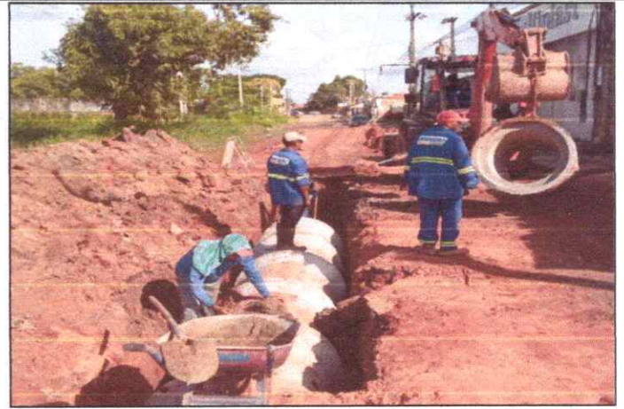
Foto 17 - AV. SÃO SEBASTIÃO - VILA NOVA - TUBO DE CONCRETO ARMADO PA2 - D= 0,80 M.
