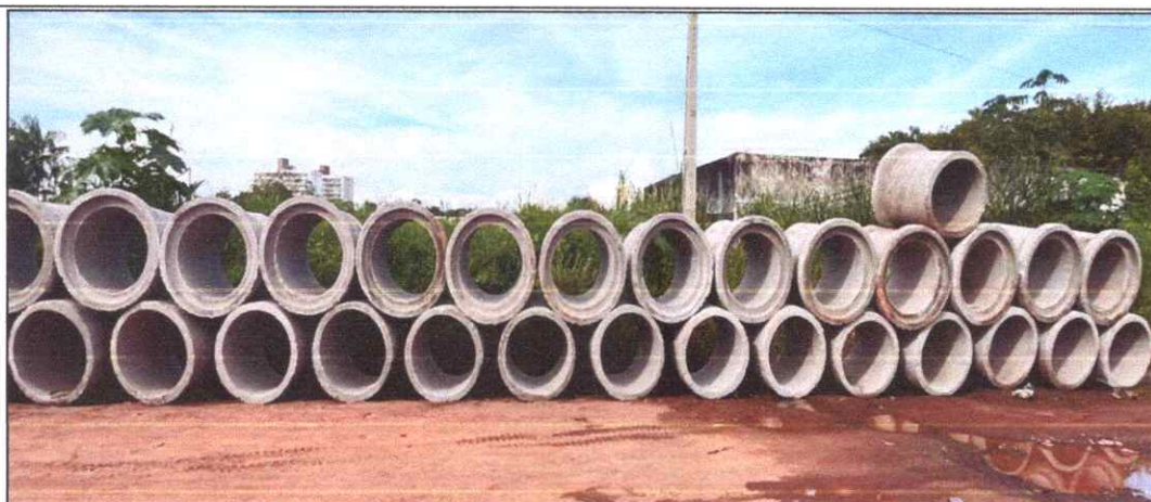
Foto 10 - AV. SÃO SEBASTIÃO - VILA NOVA - TUBO DE CONCRETO ARMADO PA2 - D= 0,80 M.
