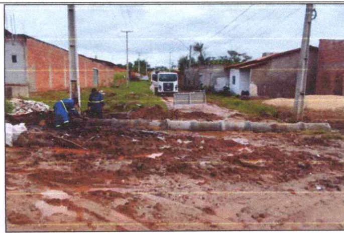
Foto 25 - R. RAIMUNDO BANDEIRA – CINCO ESTRELA - TUBO DE CONCRETO ARMADO PA2 - D= 0,40 M.
