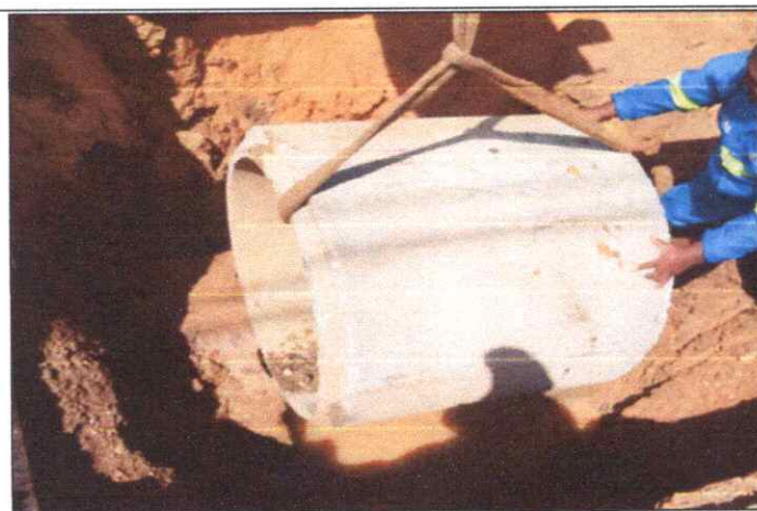
Foto 24 - R. LEÔNICIO PÍRES DOURADO – CENTRO - TUBO DE CONCRETO ARMADO PA2 - D= 0,80 M.
