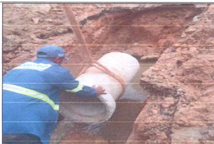
Foto 21 – R. DOM PEDRO II – BEIRA RIO - TUBO DE CONCRETO ARMADO PA2 - D= 0,40 M.
