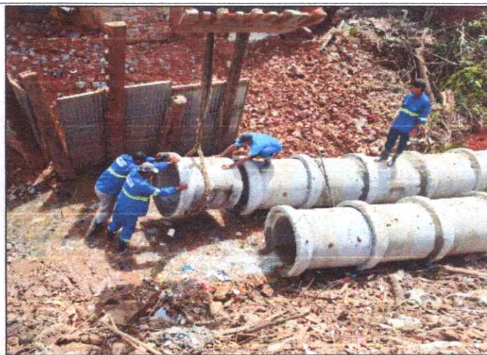
Foto 12 - R. SETE DE SETEMBRO - BACURI - TUBO DE CONCRETO ARMADO PA2 - D= 0,80 M.
