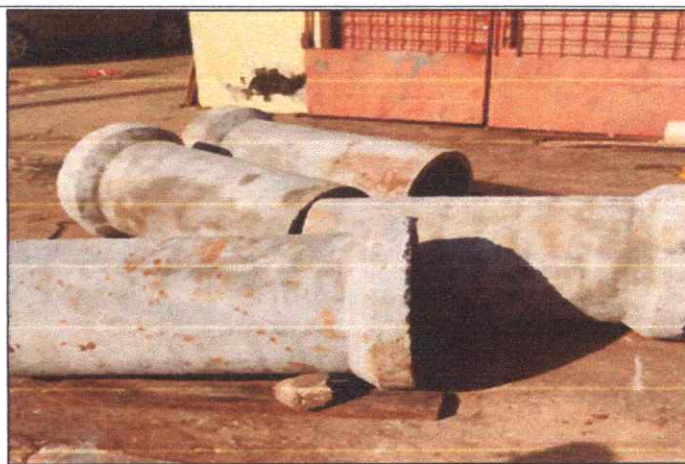
Foto 23 - R. DOM PEDRO II – BEIRA RIO - TUBO DE CONCRETO ARMADO PA2 - D= 0,40 M.
