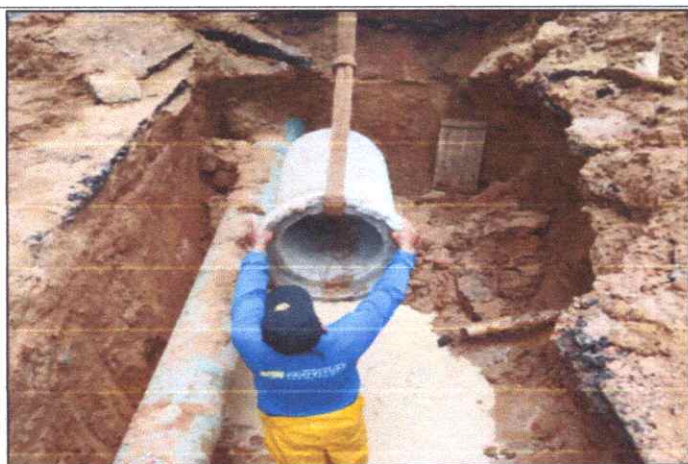
Foto 22 - R. DOM PEDRO II – BEIRA RIO - TUBO DE CONCRETO ARMADO PA2 - D= 0,40 M.
