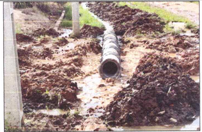
Foto 19 - RES. POR DO SOL - SANTA INÊS - TUBO DE CONCRETO ARMADO PA2 - D= 0,40 M.
