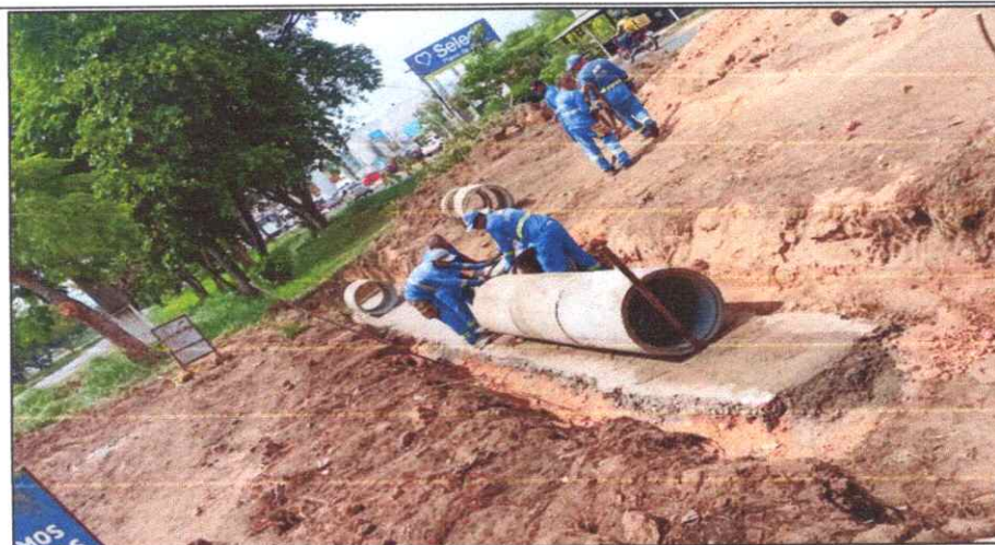
Foto 35 – BR 010 – ENTROCAMENTO - TUBO DE CONCRETO ARMADO PA2 - D= 0,80 M.
