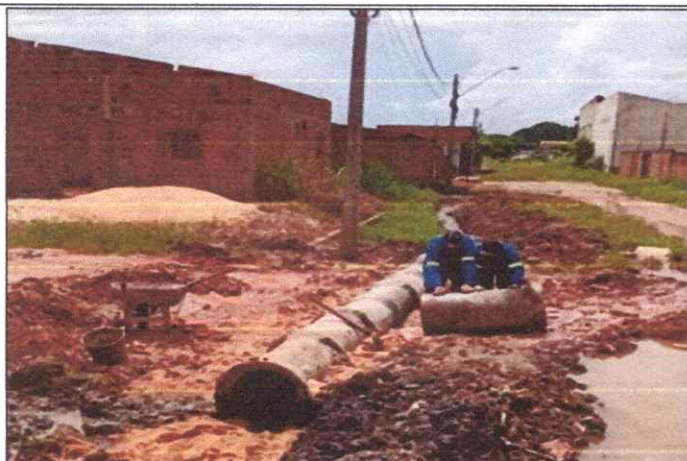
Foto 26 - R. RAIMUNDO BANDEIRA – CINCO ESTRELA - TUBO DE CONCRETO ARMADO PA2 - D= 0,40 M.
