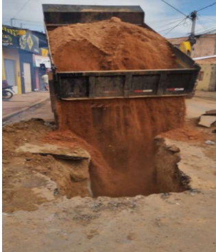
Foto 01 | DRENAGEM RUA DOM PEDRO II COM RUA BETA
